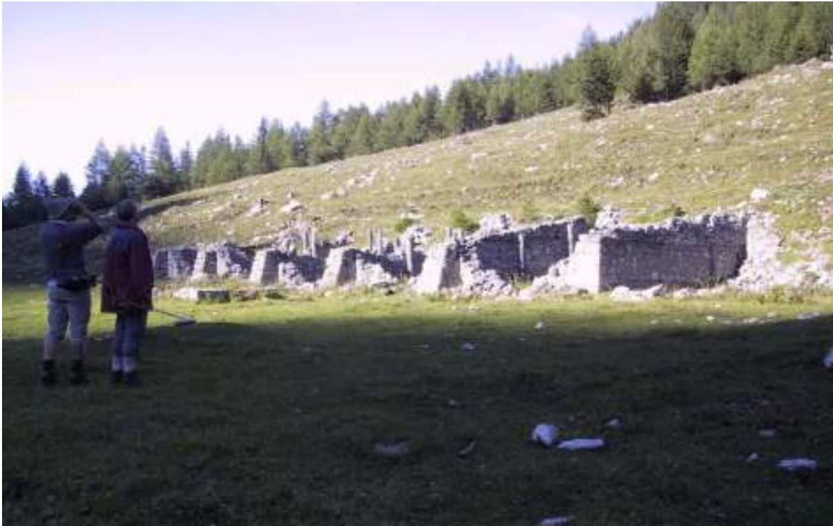
Der Blick vom Alpstall hinauf zur Anschüttung der Lugauer-Plan-Lawine dokumentiert den schlecht gewählten Bauplatz.
